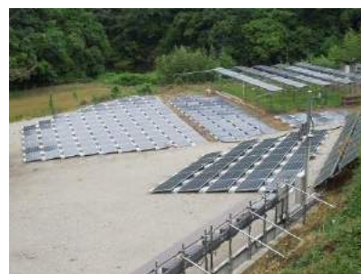
完成した北第3期発電所
