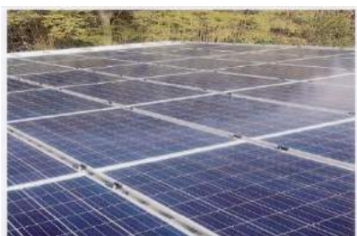
農舎屋根に設置されたパネル
