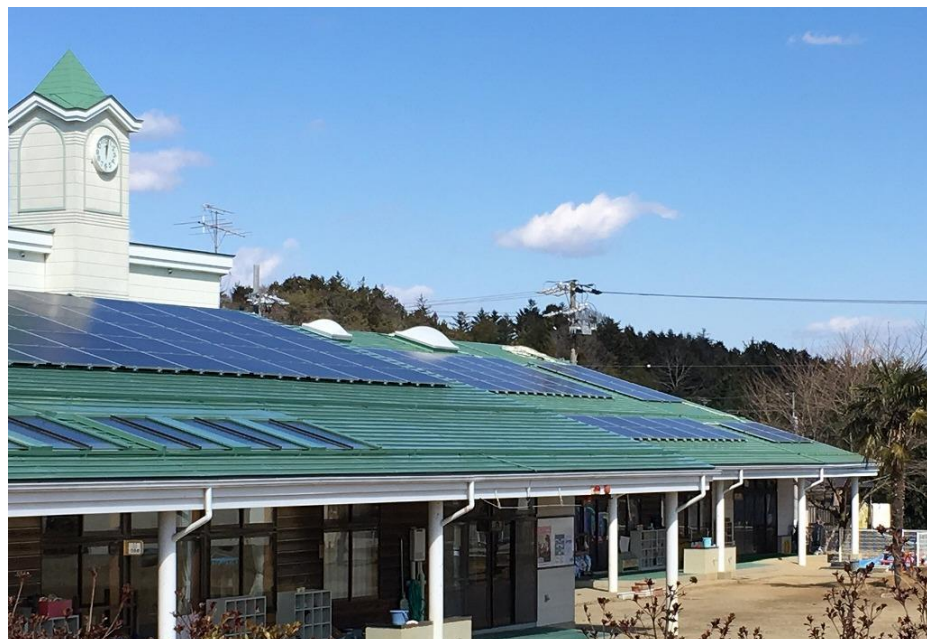
パネルが設置された下條村保育所
