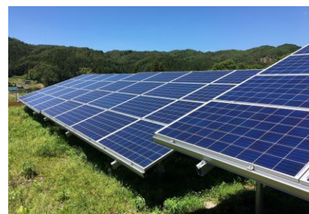
新野野立て発電所
