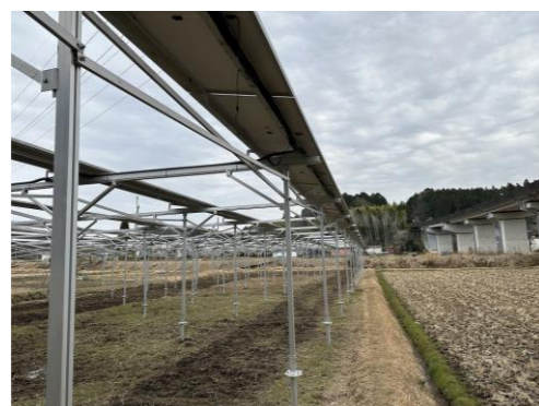
ソーラーシェアリング発電所 (愛知県内)
