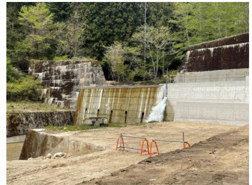
砂防えん堤に設置された取水設備
