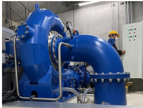
発電所内に設置された水車
