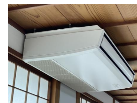
大会議室に設置した高効率空調
