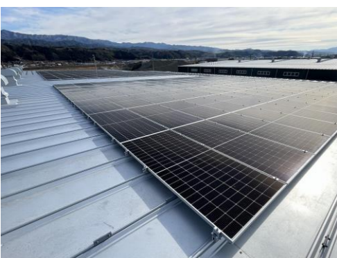
企業の屋根に設置したパネル (飯田市内)
