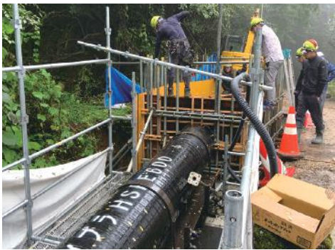
発電所へ水を送る水圧管は、大部分を林道下へ埋設しています。林道の橋には、水管橋を設置しました。(2022年9月)
