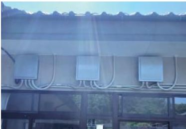
新品に交換したパワーコンディショナー
