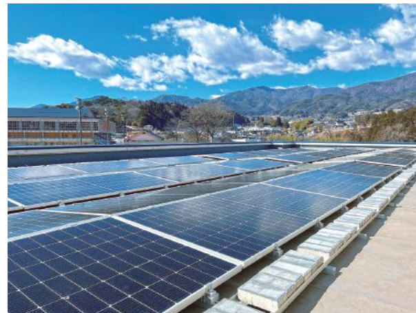
高森町民体育館に設置したパネル
