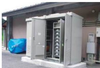
泰阜村パネル・蓄電池導入事業
